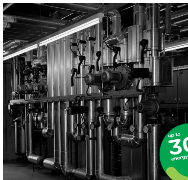
Szivattyúállomást vezérlő ATV 12 készülék (▲)
